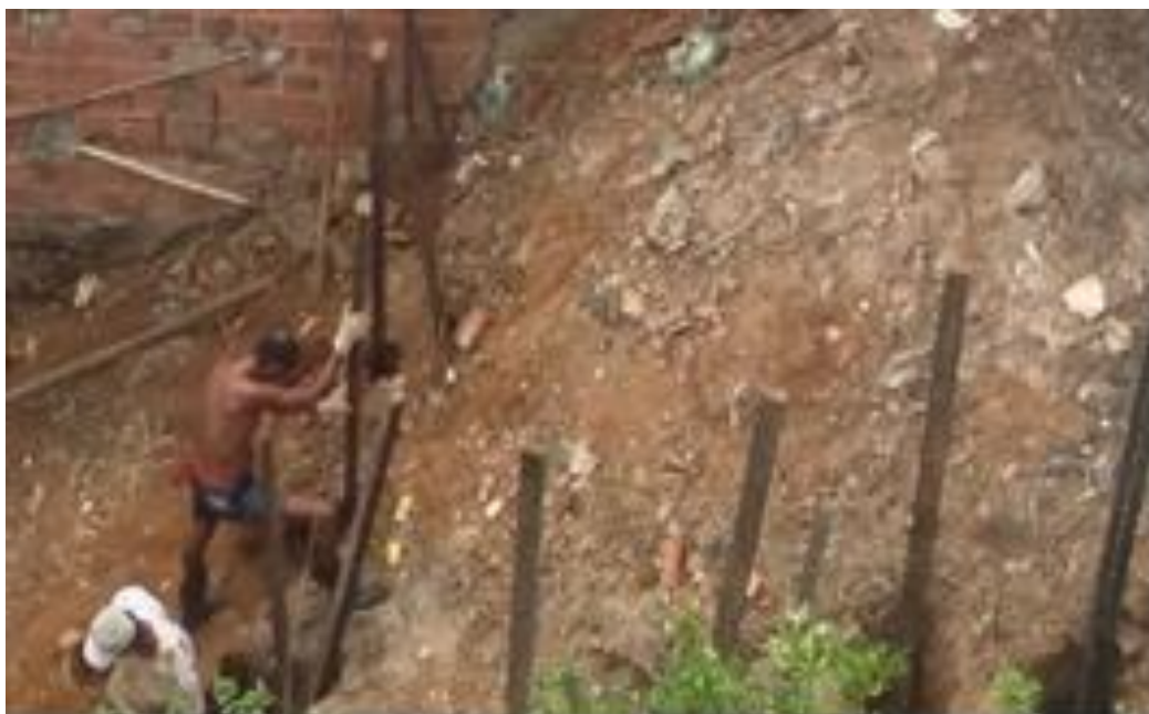
Figura 4 - Cultura de construção sem autorização pública Fonte: Acervo da equipe do Curuzu – Projeto Cidades Internas
