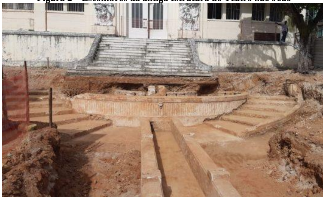
Figura 2 – Escombros da antiga estrutura do Teatro São João
